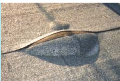
boven: renovatie sporthallen Amsterdam links: veel voorkomend probleem in een dakbedekking
